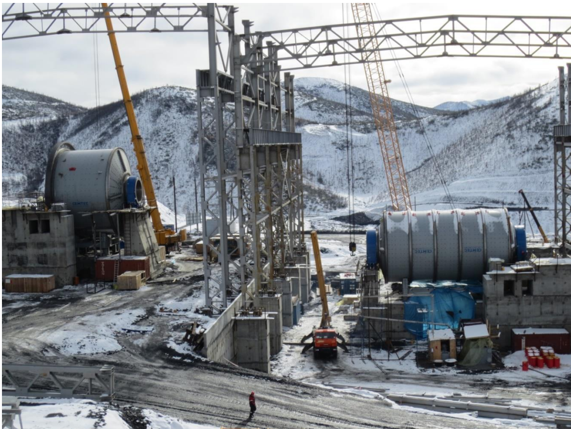
Teilschlüsselfertige Golderzmahlanlage mit einer Produktionsleistung von 1.300tph mit einer 15MW Semiautogenmühle und einer 18MW Kugelmühle in Russland.
