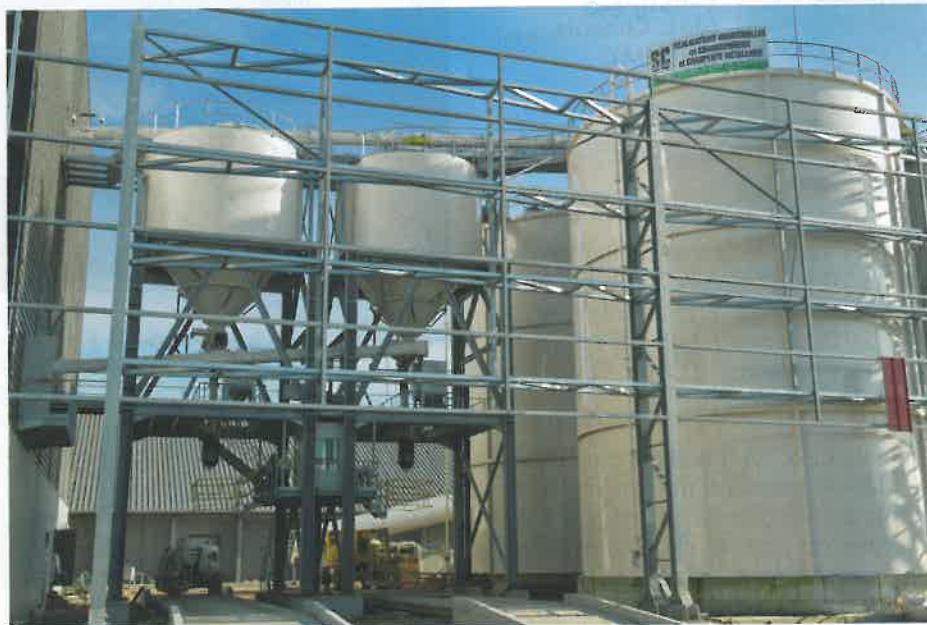
► A droite, les silos pour ciment ORHAND de 1 500 tonnes, à gauche les trémies et les manches de chargement dépoussiérées IMTEC pour expédition en vrac / Right, the ORHAND silos for cement of 1,500 tons, left the hoppers and the IMTEC loading spouts for bulk delivery (doc. Ciments KERCIM).
