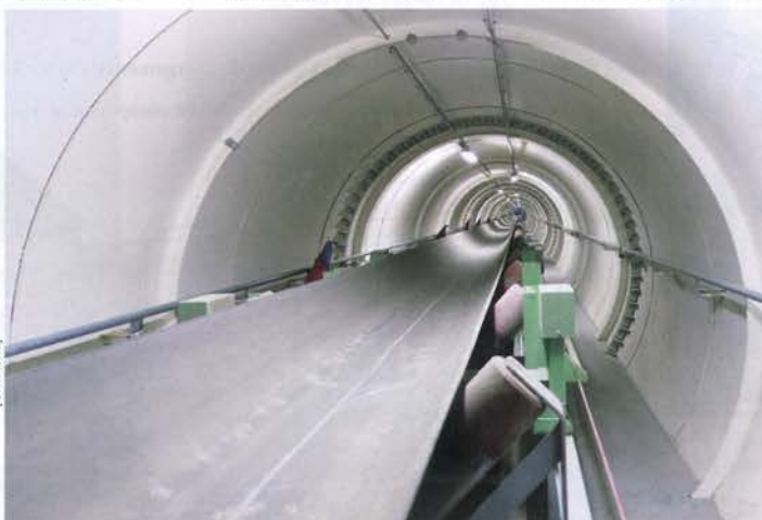
Les principaux tapis convoyeurs, assurant le transfert des matières premières entre les différents halls, sont confinés dans des tubes métalliques.
